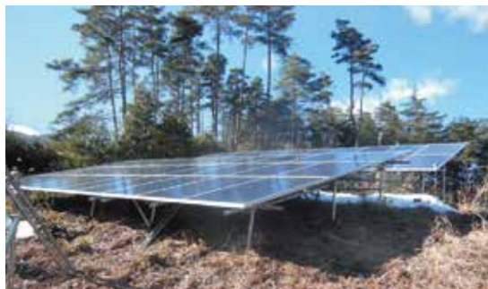
白州発電所 1 号機 9.9kW
